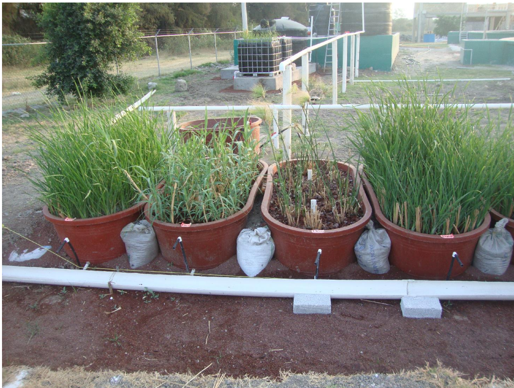
Figura 1. Humedales construidos instalados en la planta tratadora de aguas residuales del municipio de Izúcar de Matamoros.
